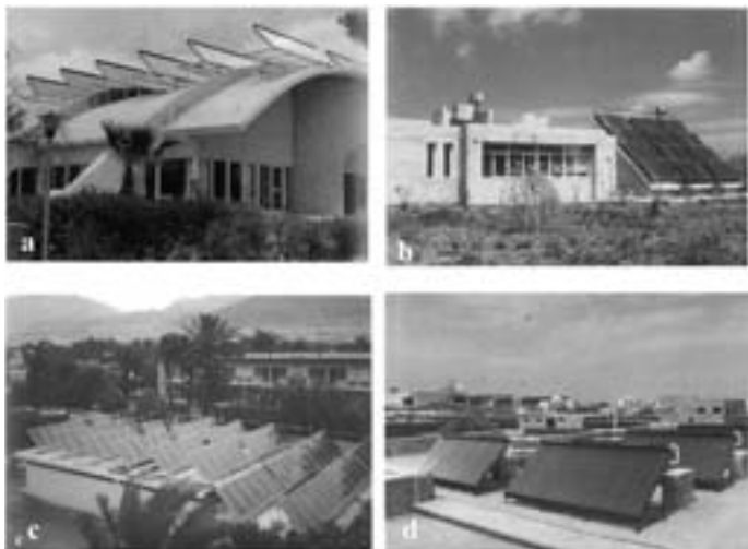
Rys.1.14. Instalacja ciepłej wody użytkowej w Jordanii (a, b – w domach; c, d – w hotelach)
