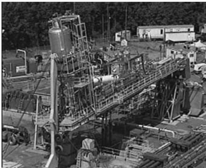
Fot.7. Testowe urządzenie lądowe zainstalowane w Trussville (Alabama) [4].
