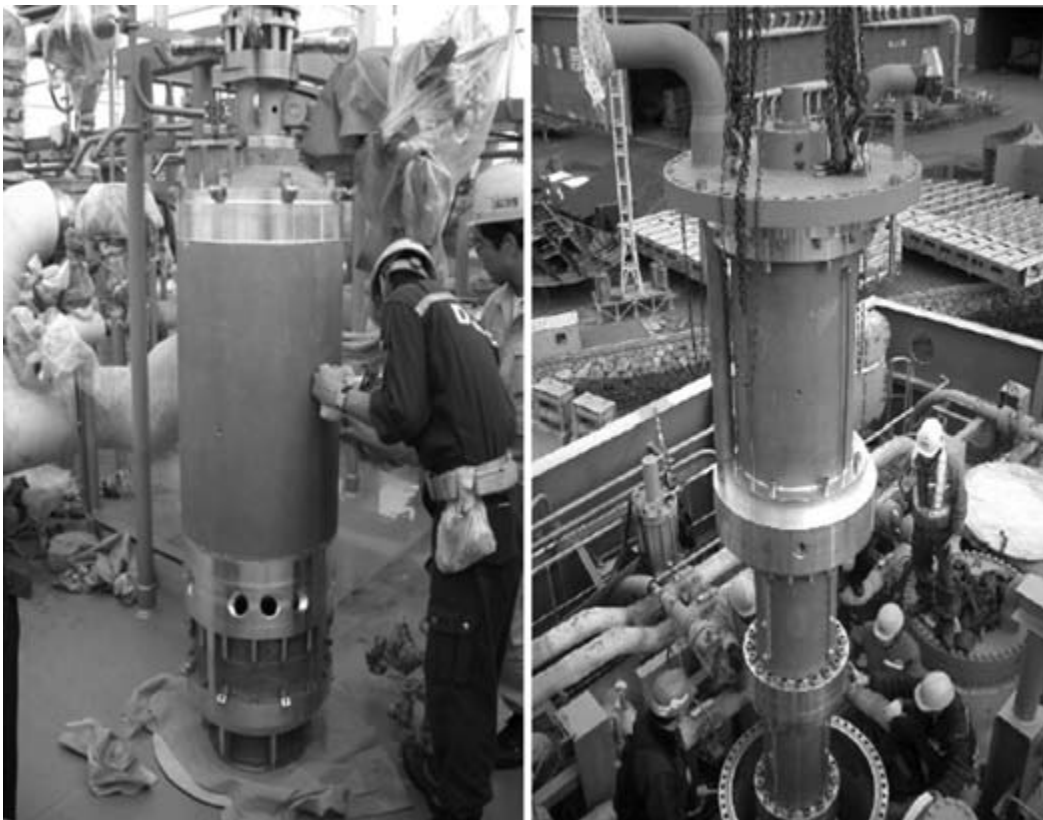
Fot.11, 12. Instalacja pompy dostarczającej oraz pompy wysokiego ciśnienia na burcie LNGRV Excellence.
